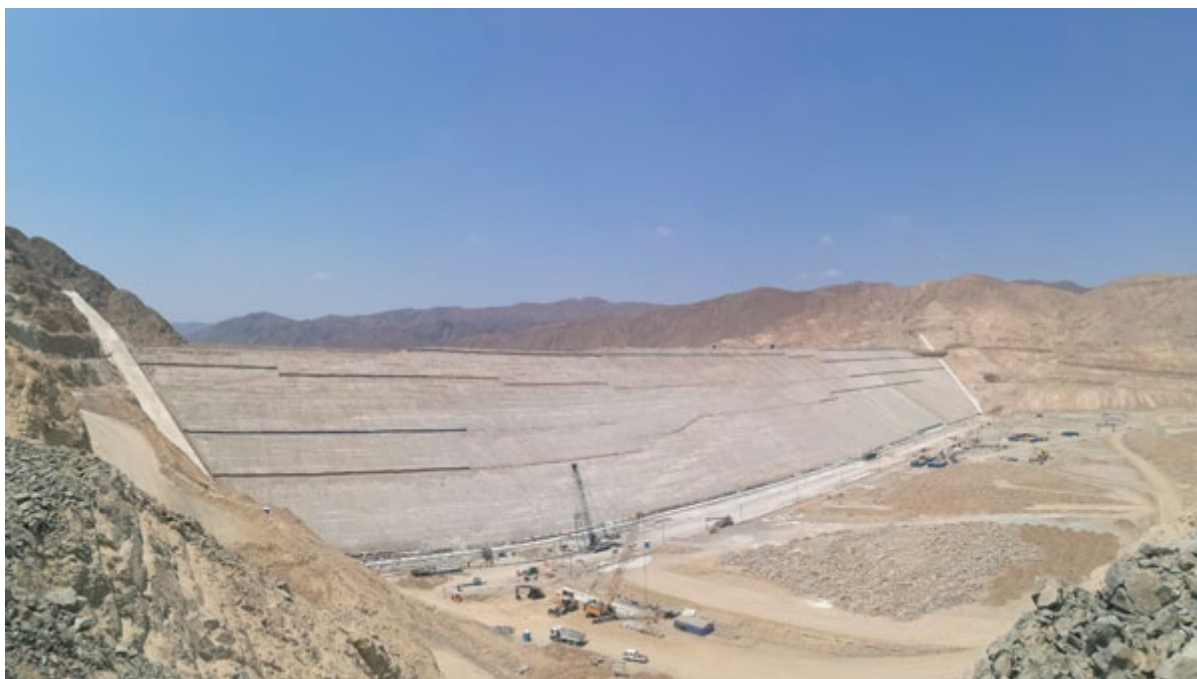
Figura 1: Chavimochic Presa Palo Redondo – Avance hasta la paralización: Rellenos 80%, Pared Diafragma 98% y Cara de Concreto 0%.
