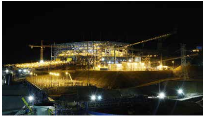
Vista nocturna de la planta concentradora de Las Bambas
